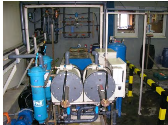
Afvalwaterreiniging bij chemie opslag Brenntag
